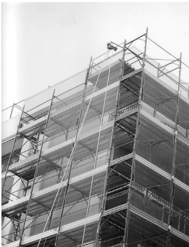
Foto 3- Idoneo ponteggio metallico con rete di protezione.
