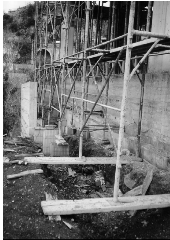
Foto 2- la base dei montanti del ponteggio metallico, “poggiano “ sul vuoto
