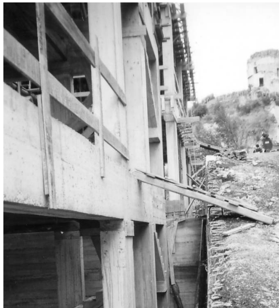
Foto 2 : Andatola sprovvista sui lati prospicienti il vuoto di idonei parapetti atti ad evitare cadute dall'alto.
