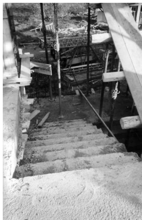
Foto 3: Scala priva di parapetto dal lato prospiciente il vuoto
