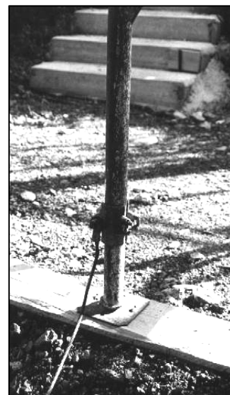
Particolare del montante di un ponteggio metallico, collegato a terra a protezione contro le scariche atmosferiche
