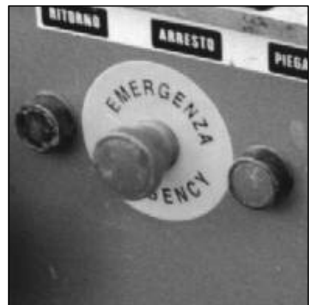
Fig. 1 – arresto di emergenza installato su macchina piegaferri immessa sul mercato con dotazione di marchio CE
